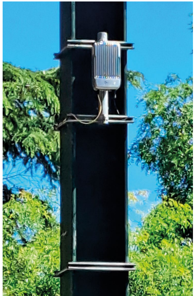
Bild 1: Die „fit and forget“-Installation der Basisstation auf einem Oberleitungsmast
