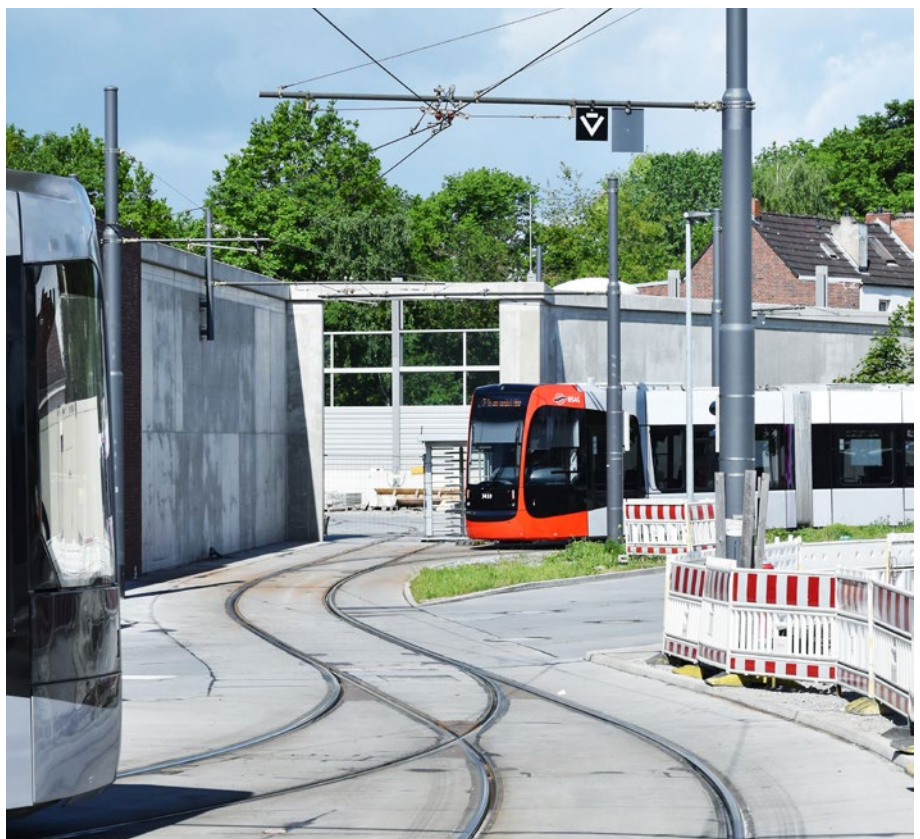
Abb. 8: Die 5,50 Meter hohe Lärmschutzwand mit dem Falttor für die nördliche Ausfahrt der Bahnen im Bauzustand vom Mai 2023.
